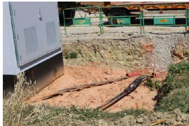
Câbles souterrains reliant les éoliennes au poste de livraison avant enfouissement (Source : Ora environnement)
