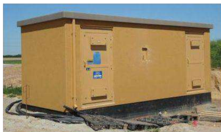
Figure 57 : Exemple de poste de livraison utilisé pour le projet éolien de Viâpres-le-Petit (Source : Intervent)
